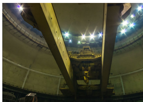
Рис. 3. Электрический полярный мостовой кран
